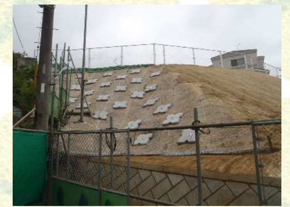
コンクリート受圧板
